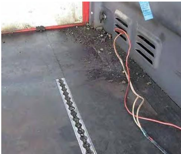
Instalim elektrik i gabuar i kryer nga përdoruesi
